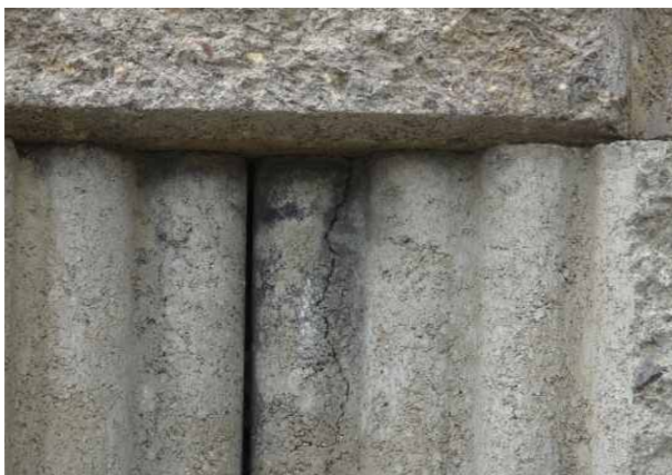
전면부 균열 0.1/0.2 10EA 3구간
