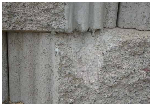
전면부 파손 0.1m x 0.2m 3구간
